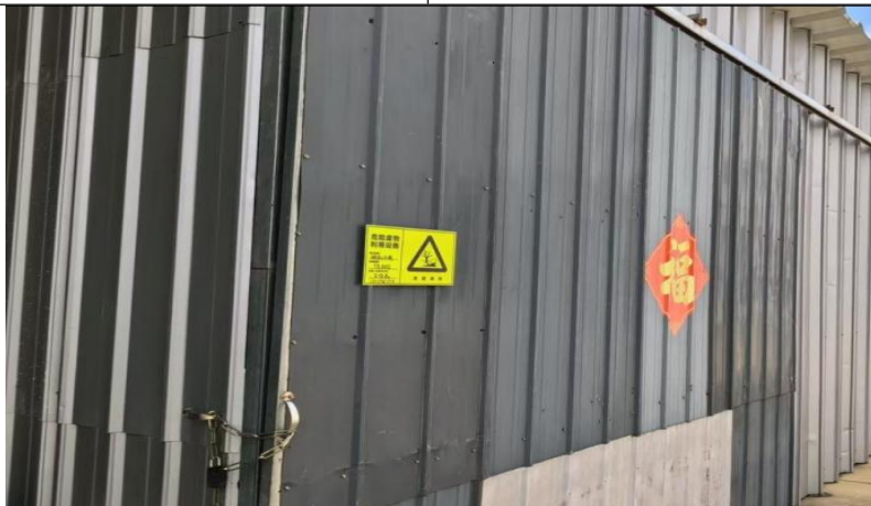
危险废物暂存间
