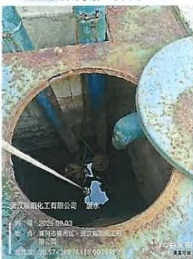
★1 DW001 污水处理站 废水出口
