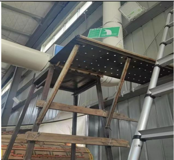
DA001废气排放口
