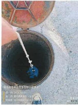
★1 生活污水总排口
