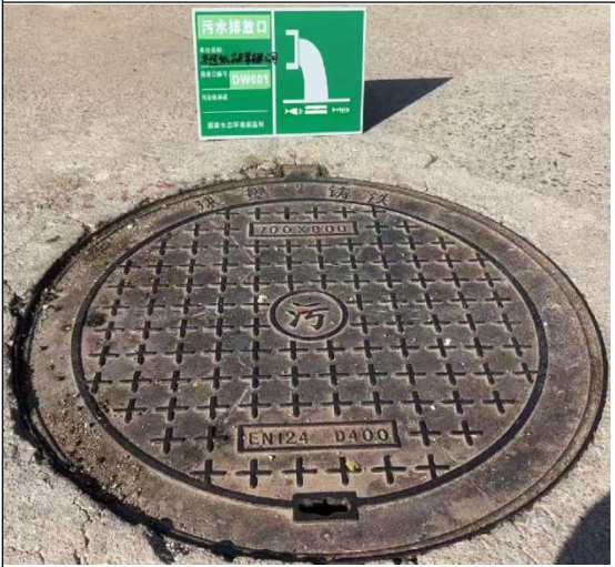
生活污水排放口及标示牌
