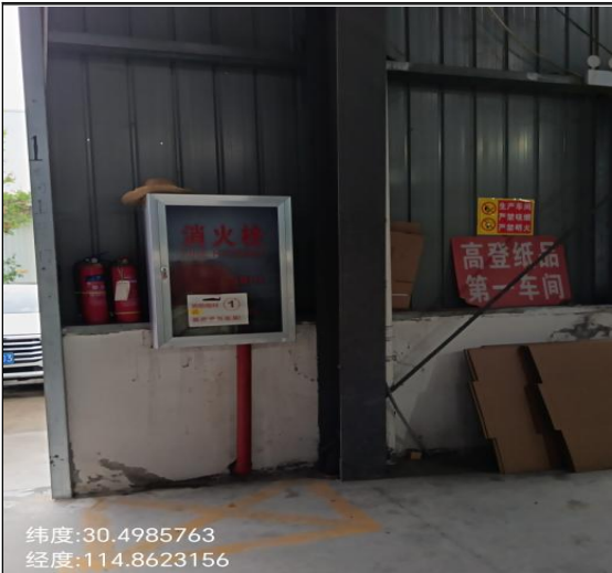
车间消防器材
