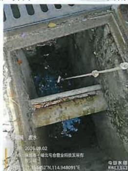
★1 生活污水排放口
