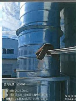
02 DA002 制芯废气排气筒
