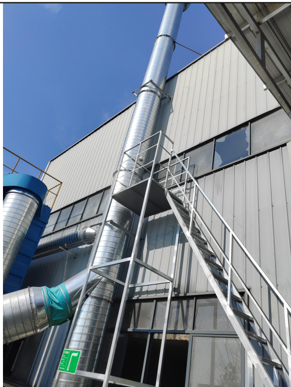
采样平台及排气筒 (DA001)
