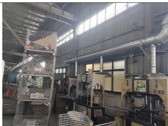
制芯废气收集设施
