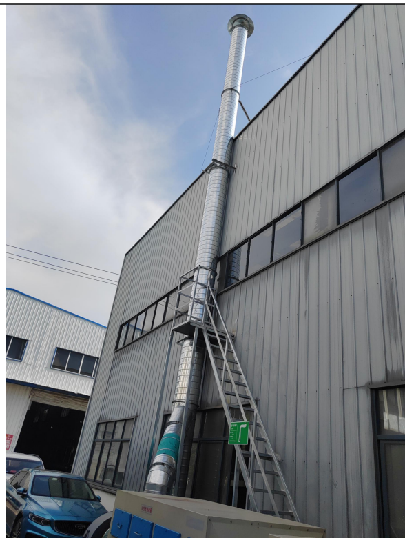
采样平台及排气筒 (DA002)
