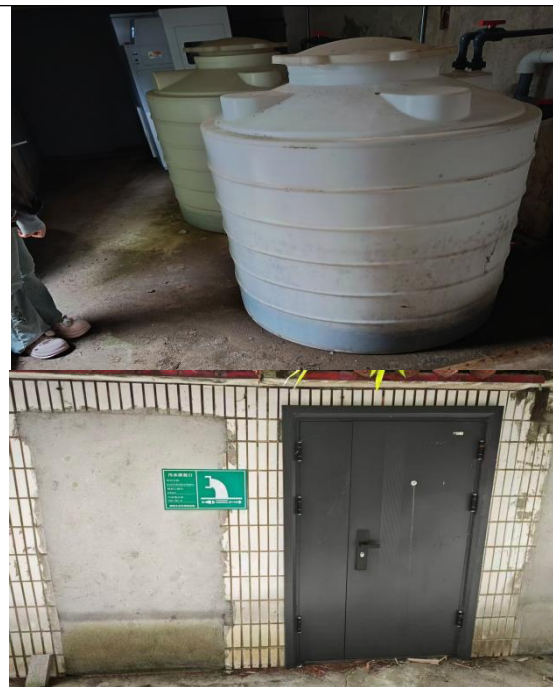
污水处理设施
