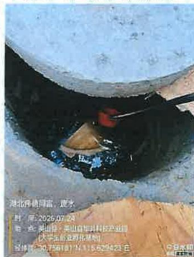
★1 DW001 生活污水总排口
