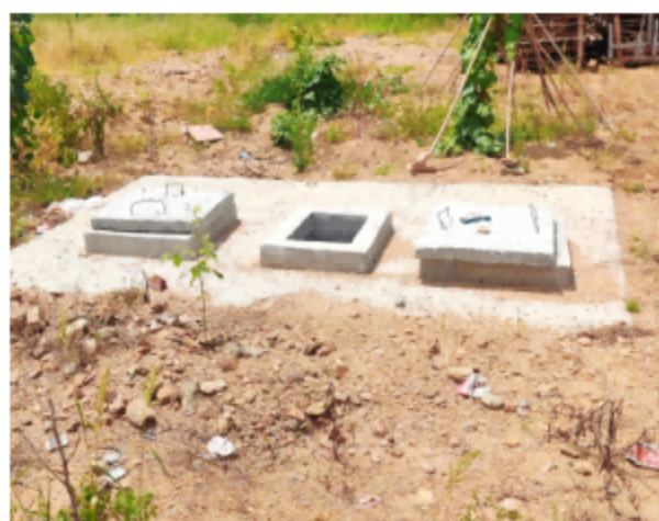
生活废水处理-化粪池
