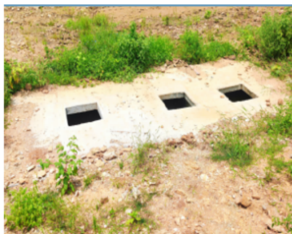
生产废水处理-地埋多级化粪池
