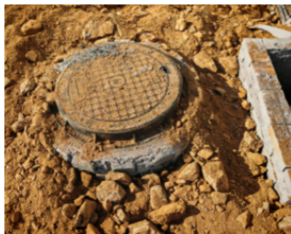
生产废水处理-地埋沉淀池
