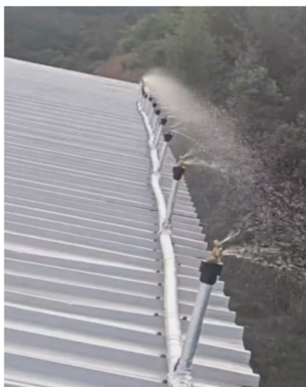
鸡舍通风口喷淋生物除臭装置
