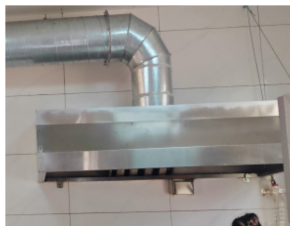
食堂油烟净化设施
