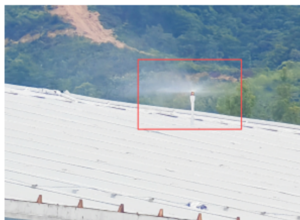
鸡舍顶部通风口喷淋除臭系统
