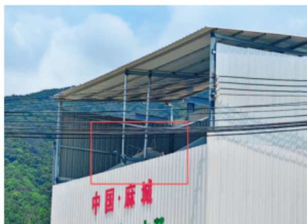
料塔滤网设施
