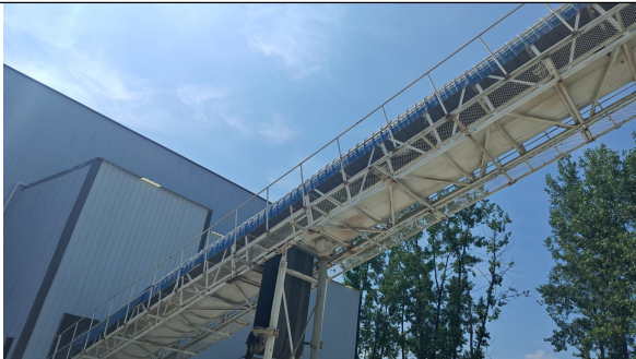
封闭皮带输送
