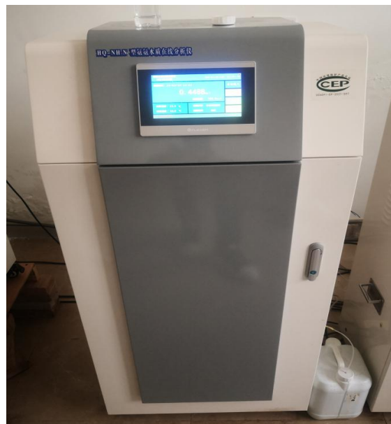
污水总排口在线监测设备（氨氮）
