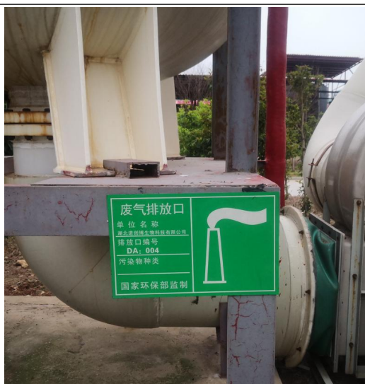
DA004 排气筒标识牌
