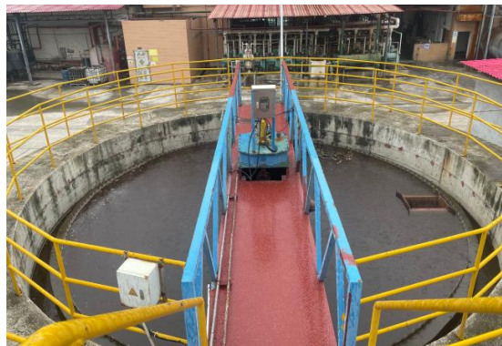
污水处理站（调节池）
