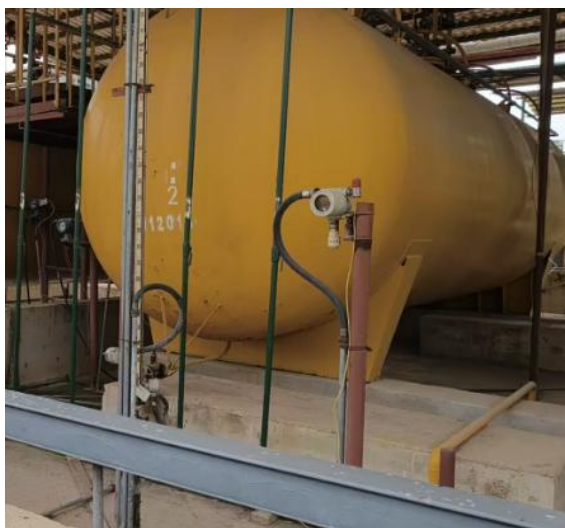
罐区泄漏报警装置
