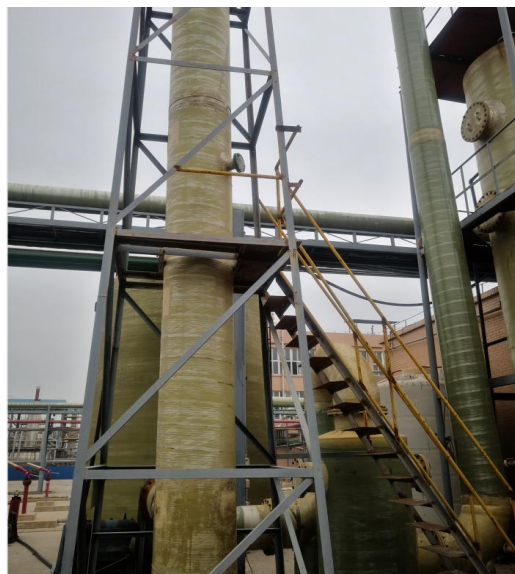
DA003 排气筒监测孔及采样平台
