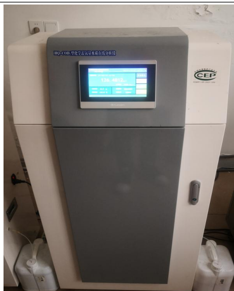
污水总排口在线监测设备（COD）
