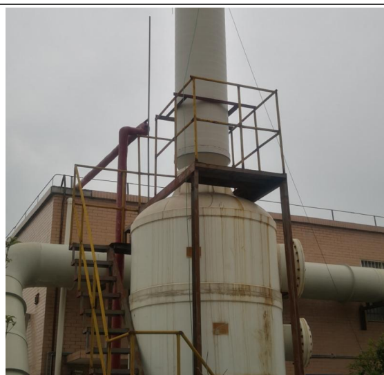
DA004 排气筒监测孔及采样平台
