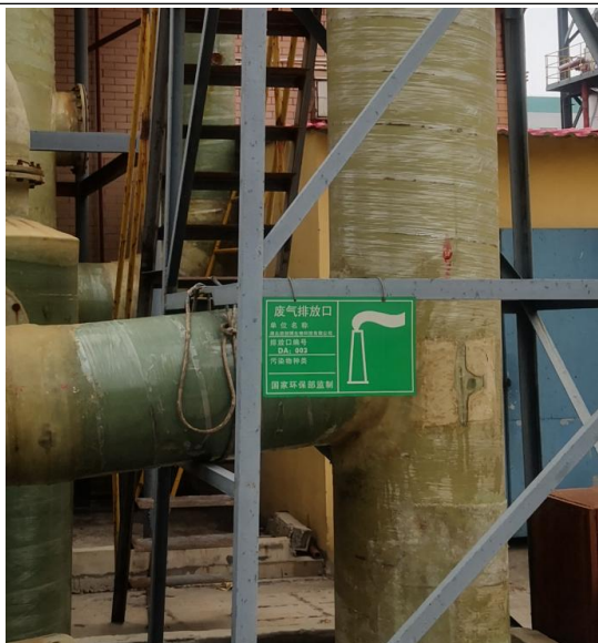
DA003 排气筒标识牌
