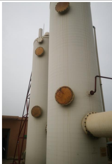
废气吸收水洗塔（合成一车间）
