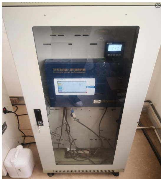
污水总排口在线监测设备（数采仪）
