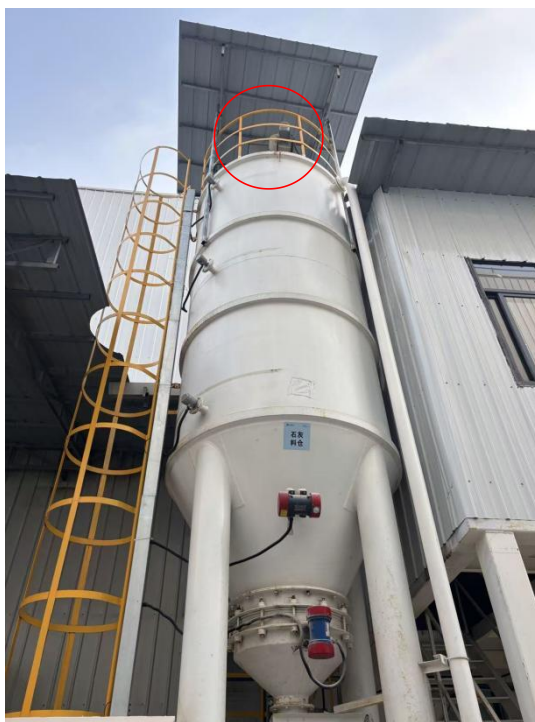
石灰仓仓顶脉冲除尘器
