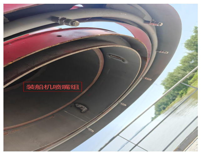
装船机喷淋设施
