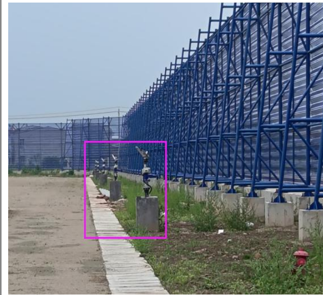
堆场区喷雾器降尘设施
