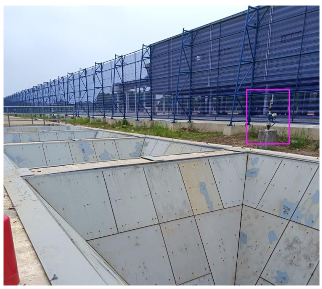
卸料口及喷雾降尘设施
