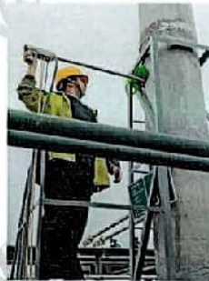
苯甲酸甲酯装置 废气排气筒出口
