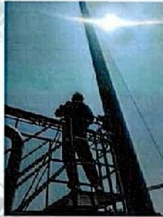
污水处理站废气排气筒 出口
