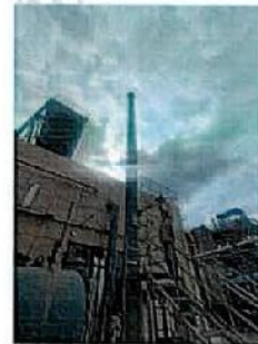
导热油锅炉废气排气筒
