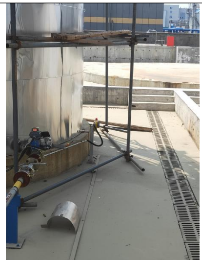
罐区有毒有害易燃易爆气体泄露检测及报警装置
