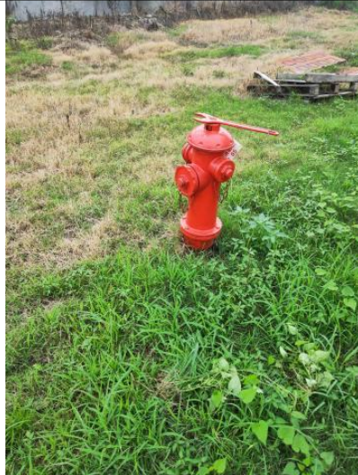
危废暂存间外消防栓
