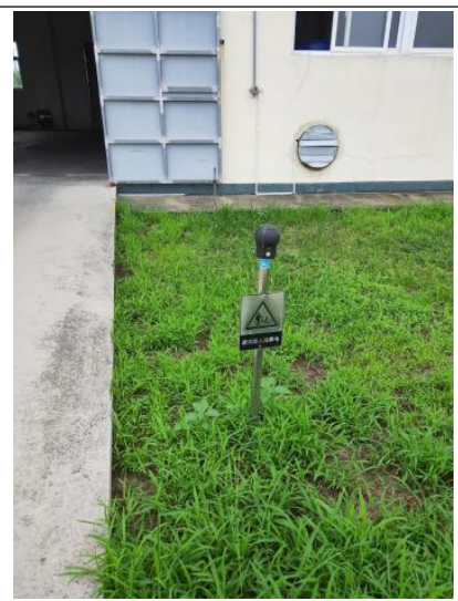
甲类仓库 1 外防静电装置
