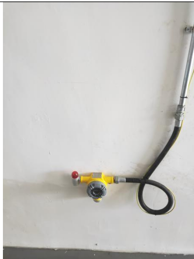
危废暂存间有毒有害易燃易爆气体泄露检测及报警装置
