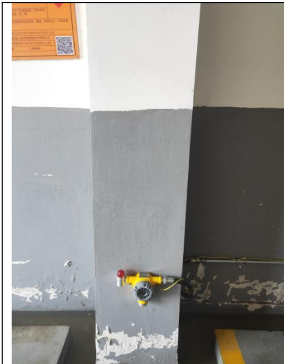
危废暂存间有毒有害易燃易爆气体泄露检测及报警装置
