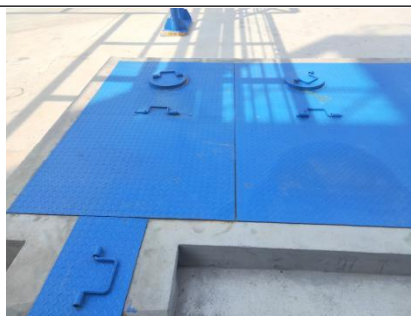
精化装置区废水收集池
