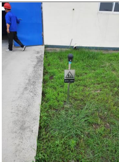
甲类仓库 1 外防静电装置
