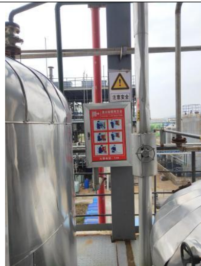
精化装置区消防栓
