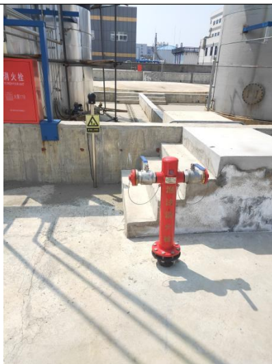
罐区泡沫灭火器和防静电装置
