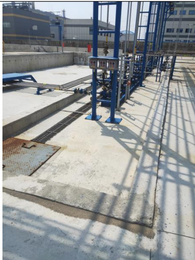
罐区卸料处围堰、收集沟和收集池
