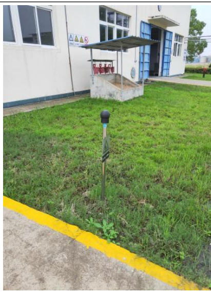
甲类仓库 2 外防静电装置
