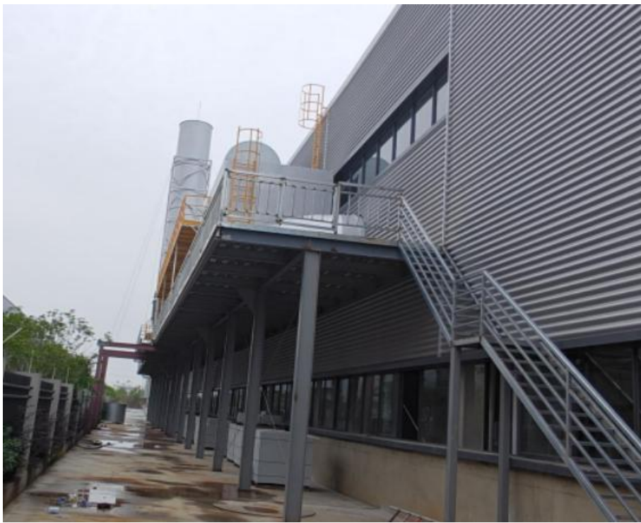
废气排气筒 DA001
