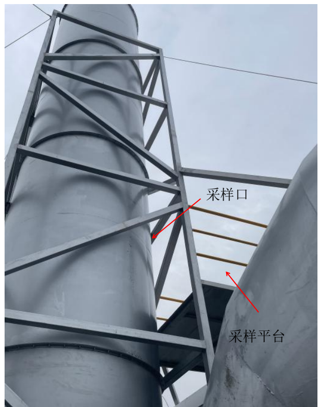
DA001 排气筒监测孔及采样平台
