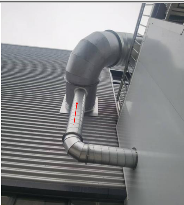
危废间废气收集管道
