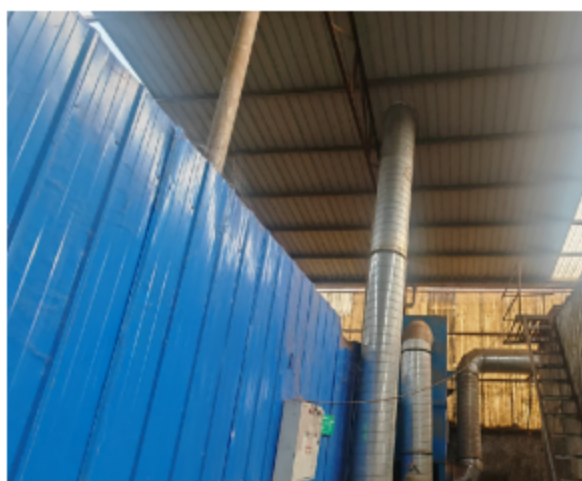
DA001 排气筒 (15m)
