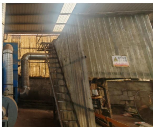
破碎、筛分、包装区封闭及废气管道
