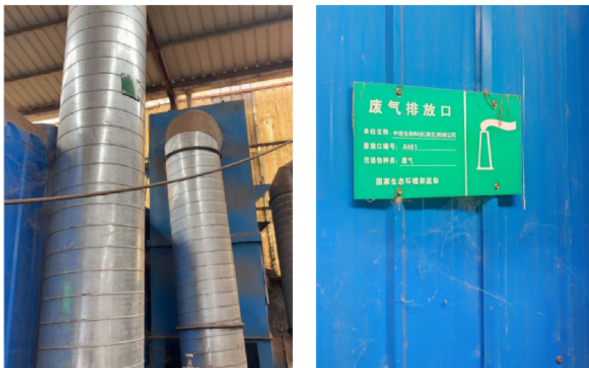
DA001 规范化设置情况(采样平台、采样孔及标识牌)
