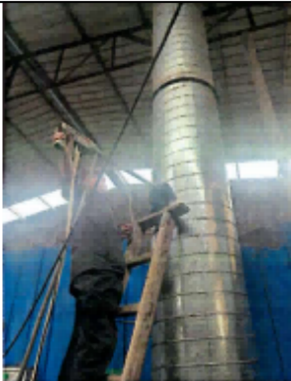
DA001 排气筒采样
