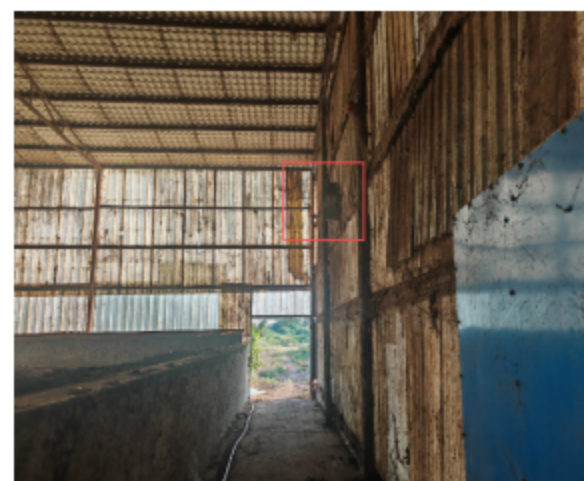
发酵车间封闭及废气收集管道
