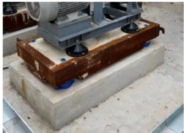
各种风机泵类基础减震
