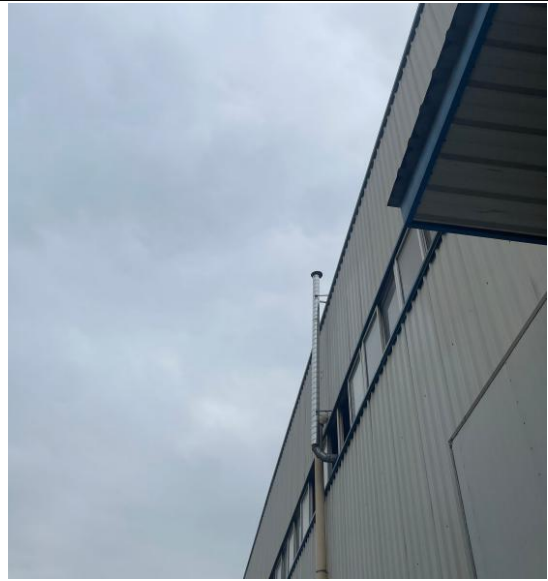
加热炉废气排气筒
