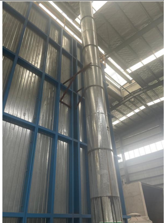
烘干固化废气排气筒
