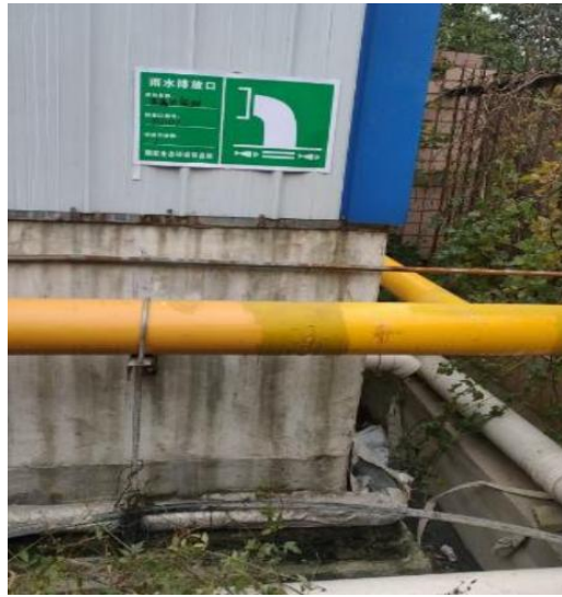
雨水排放口标识牌
