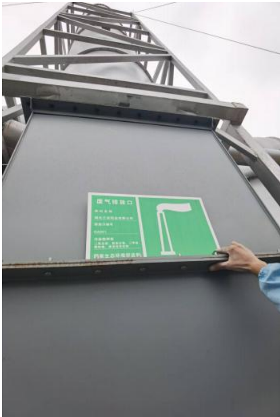
DA001 排气筒标识牌
