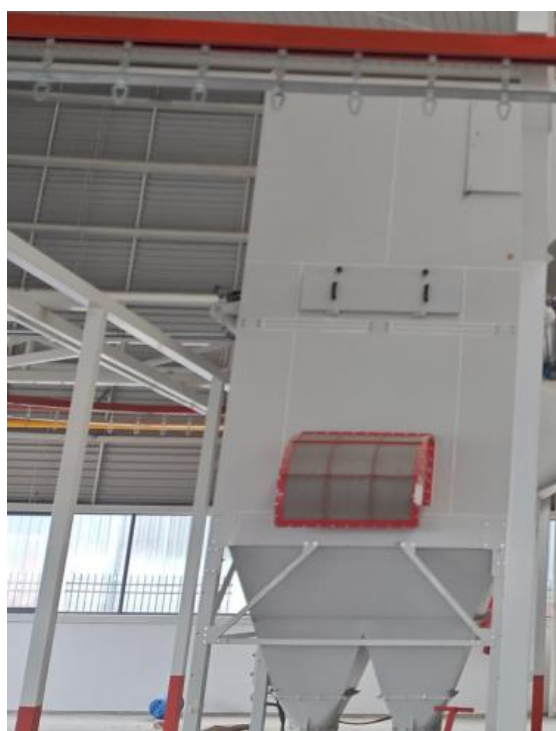
喷粉废气布袋除尘器
