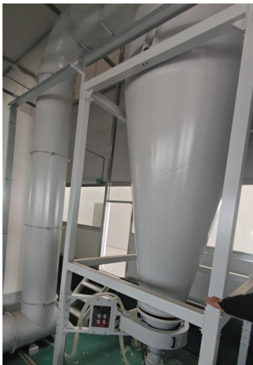
喷粉废气旋风除尘器
