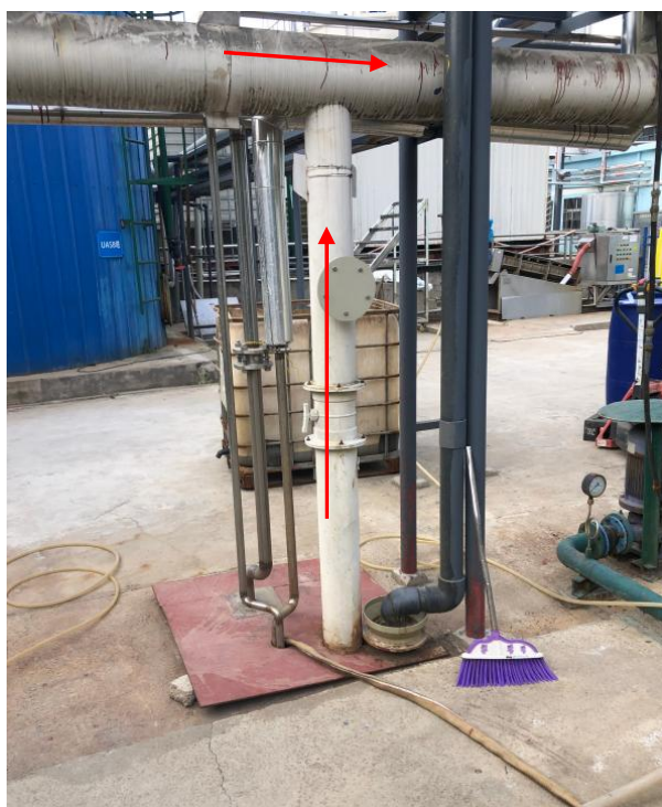
厌氧池尾气收集管道
