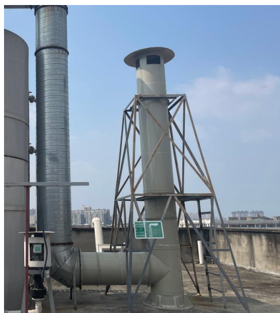
三车间废气排气筒
