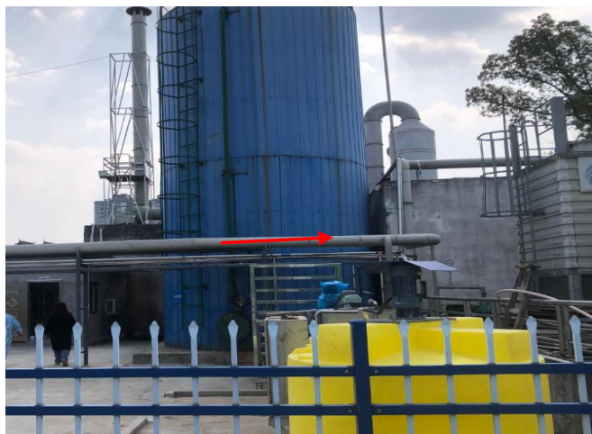
污水处理站废气主管道
