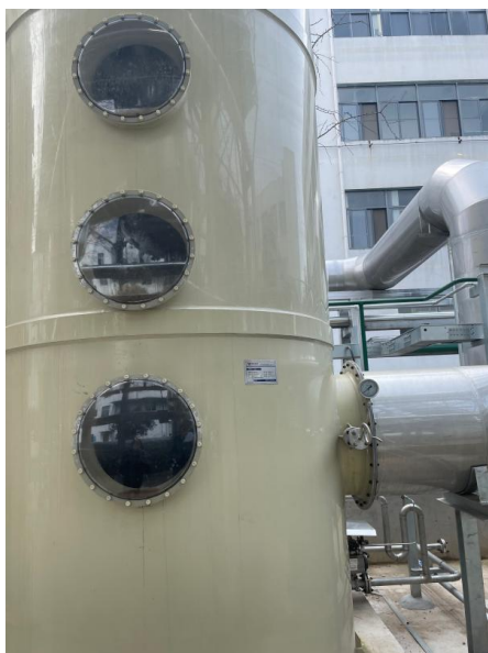
四车间外废气管道
