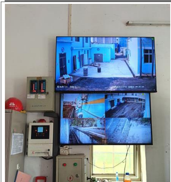
厂区监控系统
