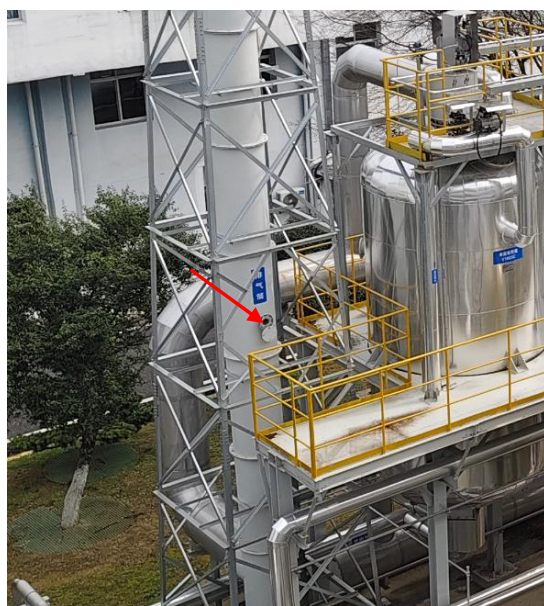
DA001 排气筒监测孔及采样平台
