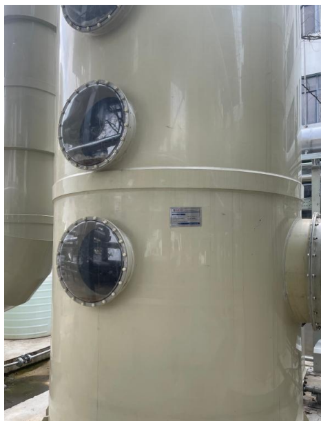
五车间外废气管道
