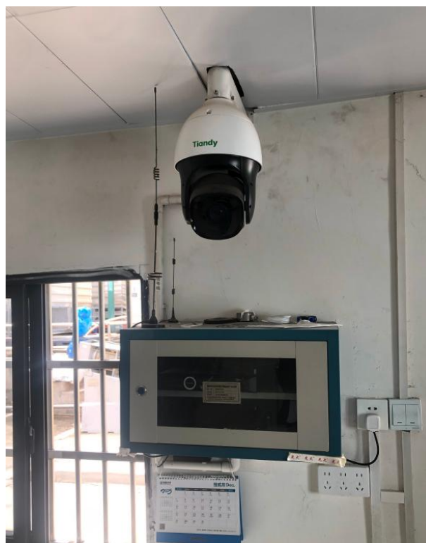
在线监测室视频监控
