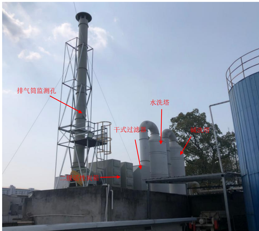
污水处理站和危废间废气治理设施
