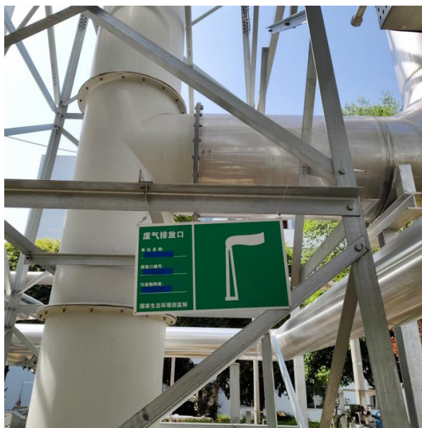
DA001 排气筒标识牌
