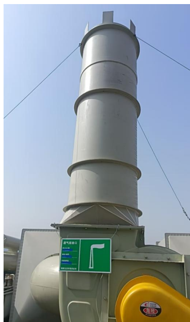
化验室废气排气筒（化验室楼顶）
