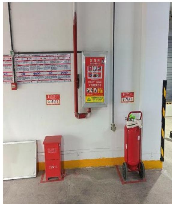
原料仓库消防器材
