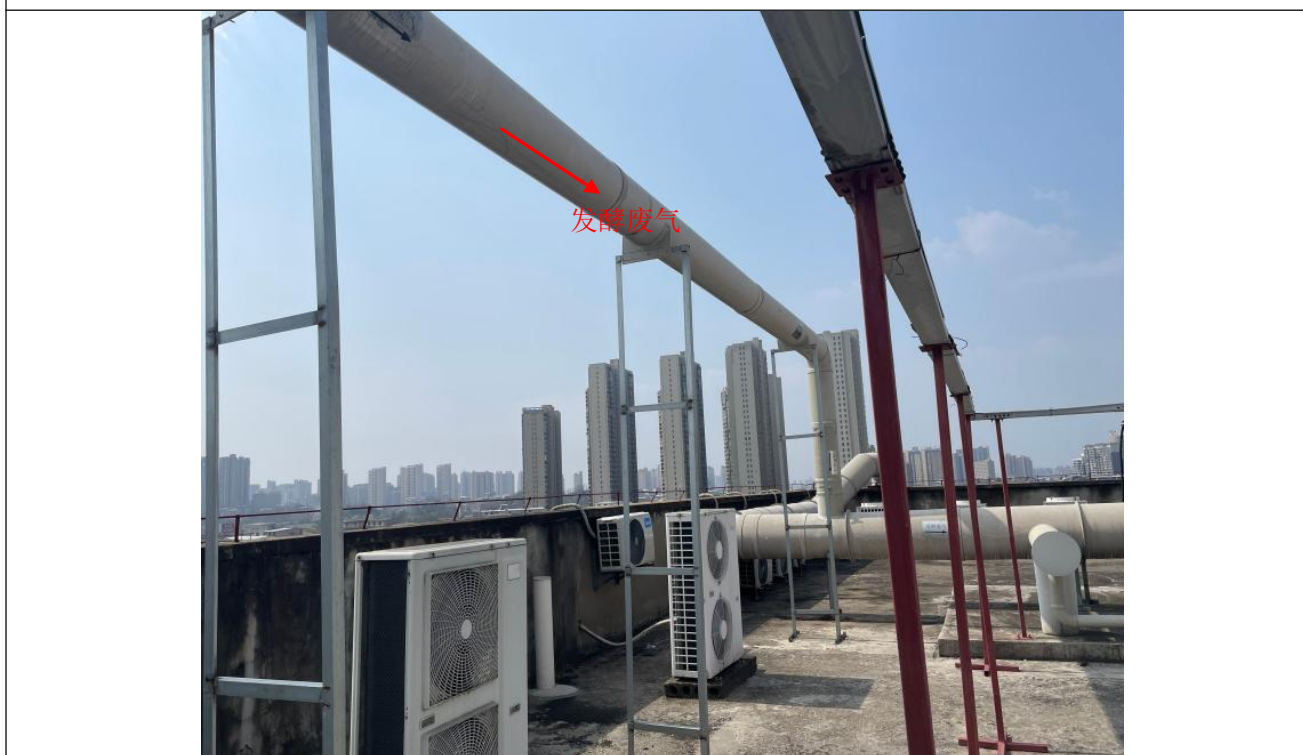
三车间废气收集管道
