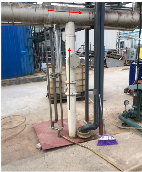
厌氧池尾气收集管道
