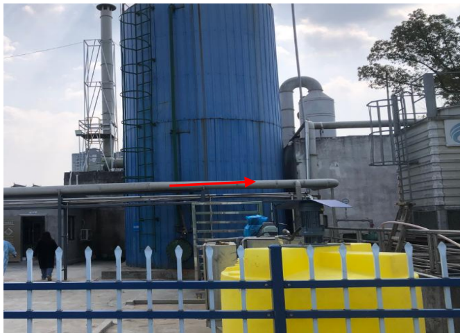
污水处理站废气主管道
