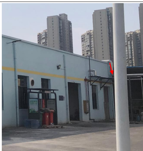
二车间外废气收集管道
