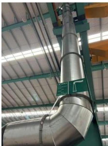
DA004 抛丸粉尘排放口 2#标识牌照片
