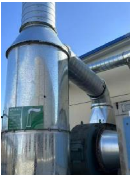
DA003 危废间废气排放口标识牌照片
