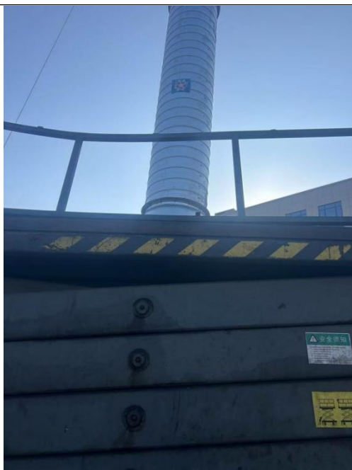
DA003 危废间废气排放口采样孔照片
