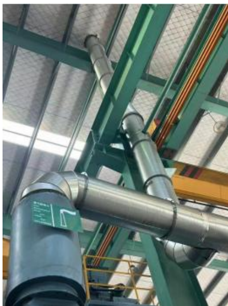
DA001 抛丸粉尘排放口 1#标识牌照片
