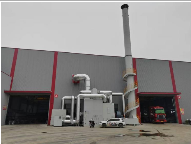
DA002 喷漆排放口照片
