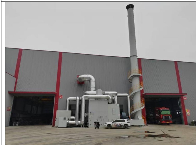
干式过滤+沸石转轮浓缩+催化燃烧装置
