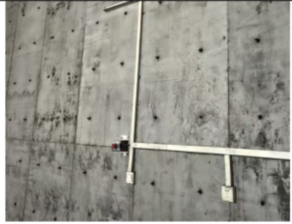
探伤室南墙急停按钮
