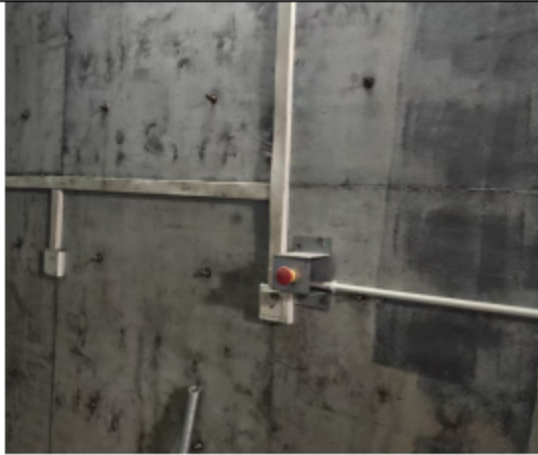
探伤室北墙急停按钮
