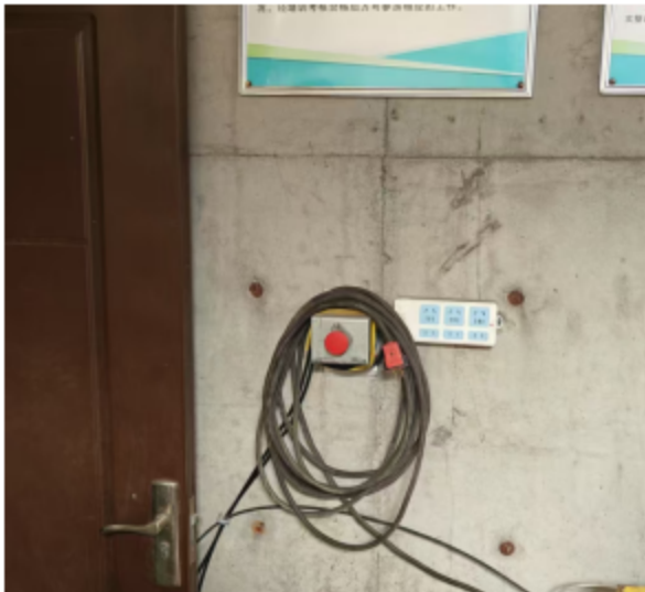
操作位处安装紧急停机按钮
