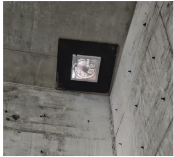
探伤室通风设施
