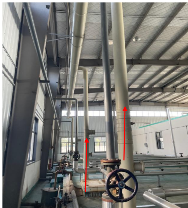
酸化池废气收集管道
