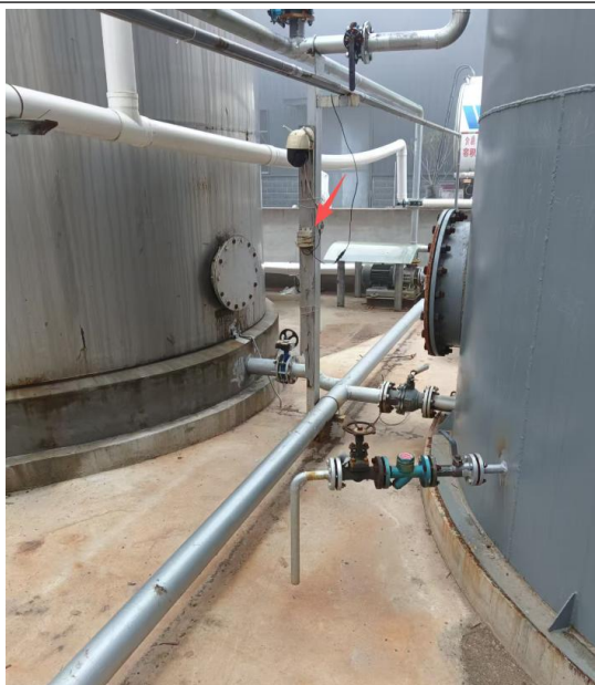
硫酸罐泄漏监测设备
