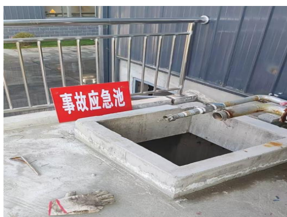
厂区事故应急池 (500m 3 )
