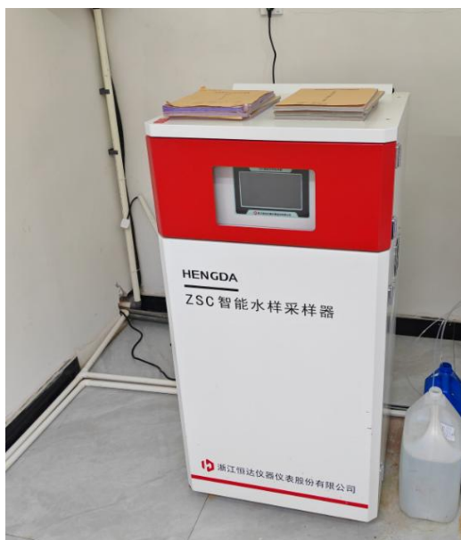
污水总排口在线监测设备水样采样器
