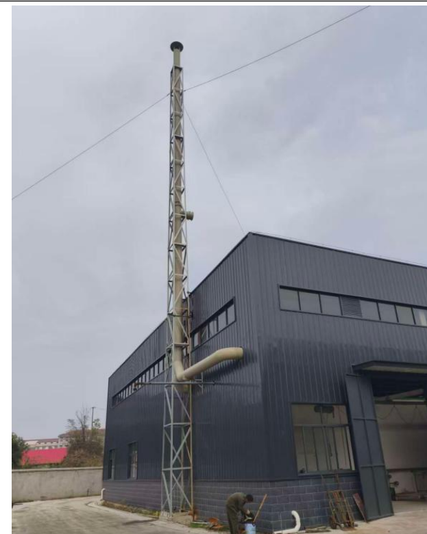
综合废气排气筒（15m）
