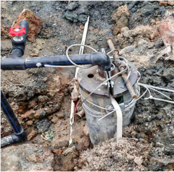
地下水监测井
