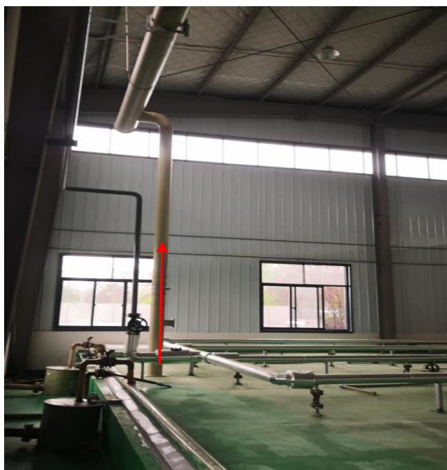
预处理水池废气收集管道
