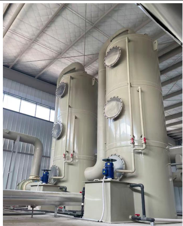
碱洗+氧化喷淋塔（废白土车间）
