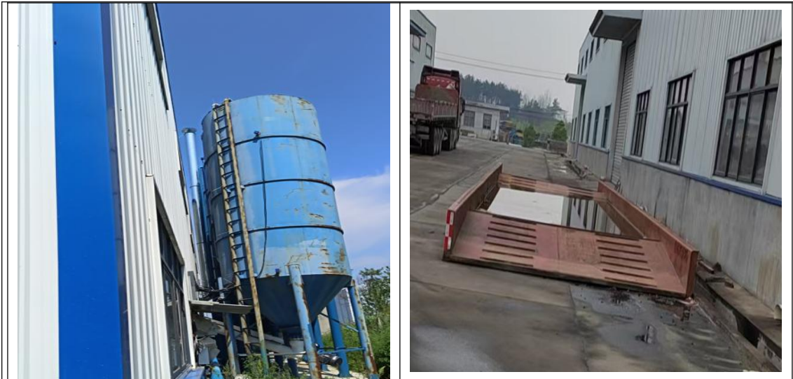
废气处理装置
