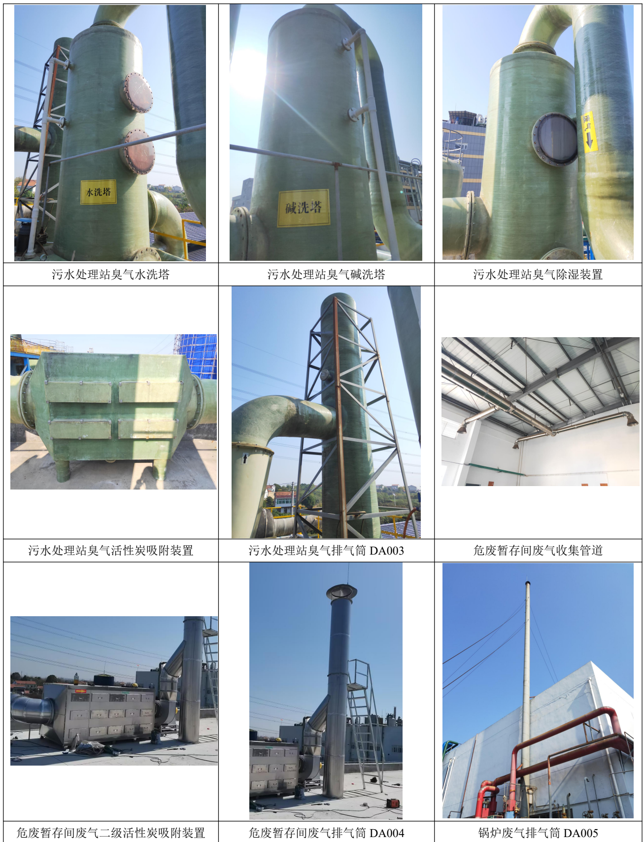
图 4.1-5 项目废气收集处理措施图
