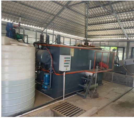
污水处理站一体化
