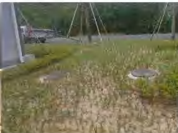
一体化污水处理设施（驿站）
