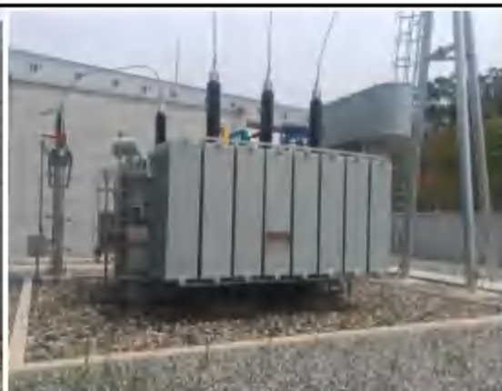
已建2#主变压器
