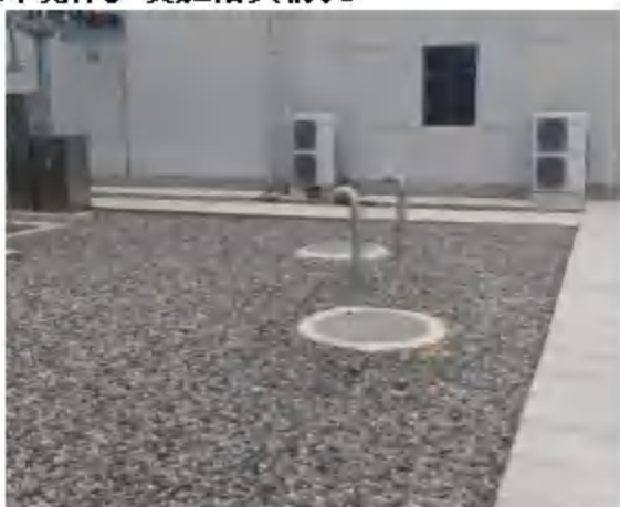
事故油池（地下）
