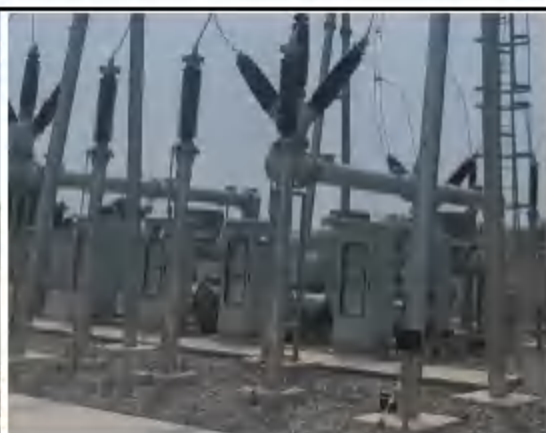
已建无功补偿装置区
