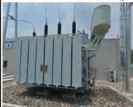
已建主变压器
