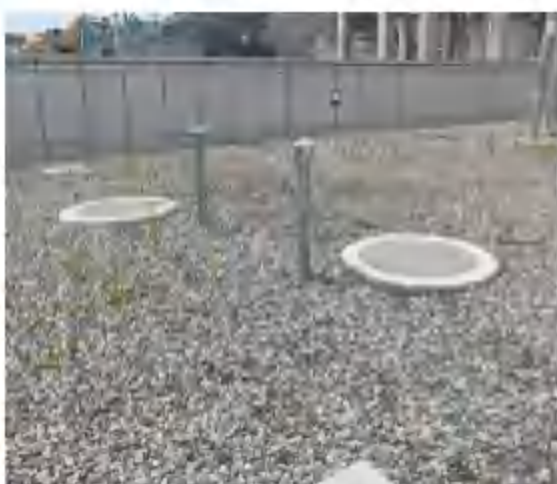
事故油池（地下）
