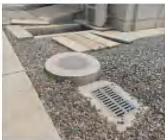
站区雨水管沟
