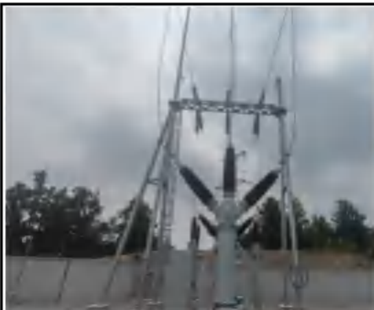
已建110kV出线侧
