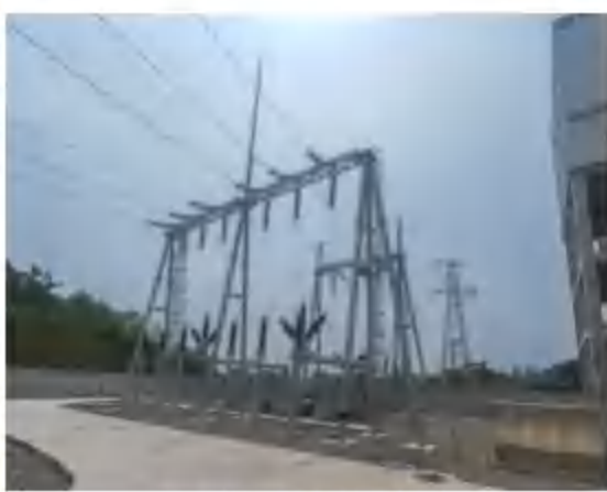
已建110kV出线侧
