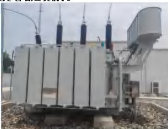
已建主变压器
