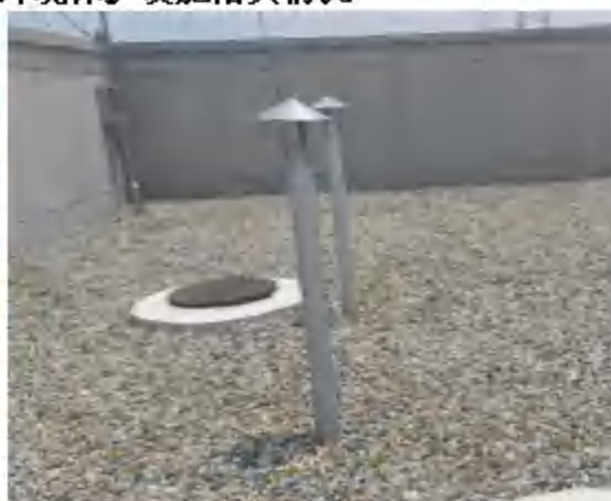
事故油池（地下）
