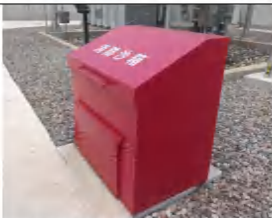
站内消防安全设施
