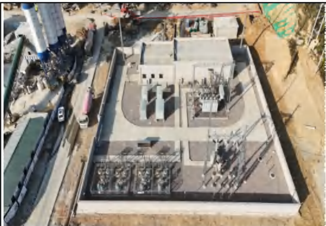
110kV 矿山变电站遥感影像图
