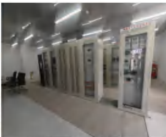
已建控制室内部
