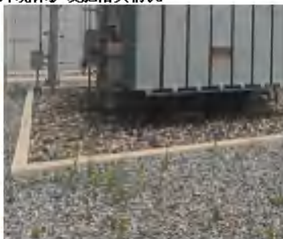
2#主变及下方集油坑
