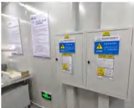
变电站内环境管理制度
