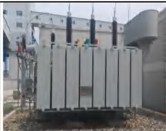
已建1#主变压器
