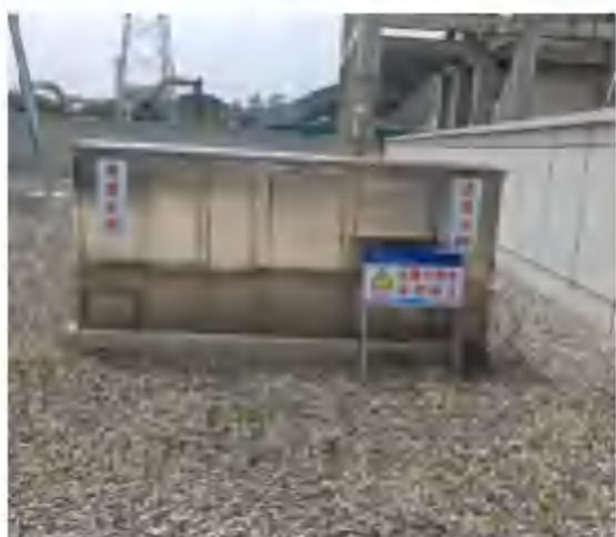
站内消防安全设施
