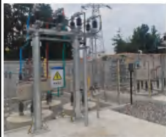
已建无功补偿装置区
