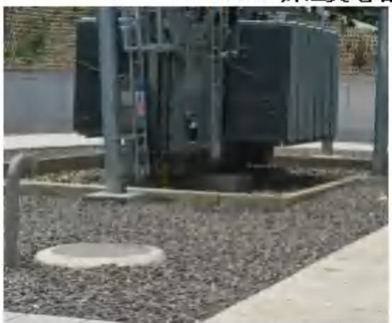
主变及下方集油坑
