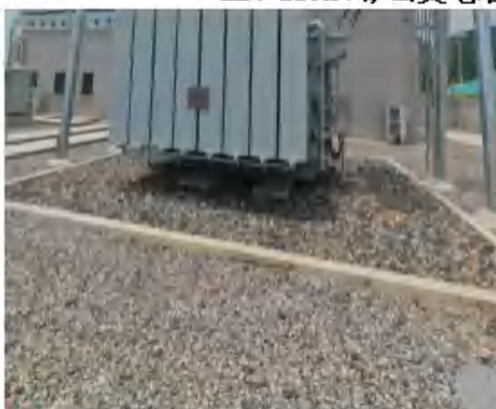
主变及下方集油坑
