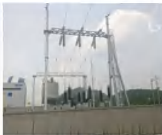
已建110kV出线侧
