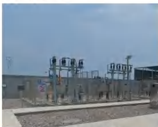
已建无功补偿装置区
