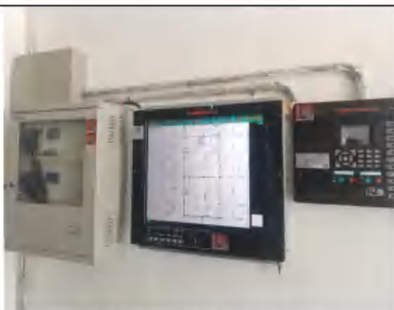
站内安全环保控制系统
