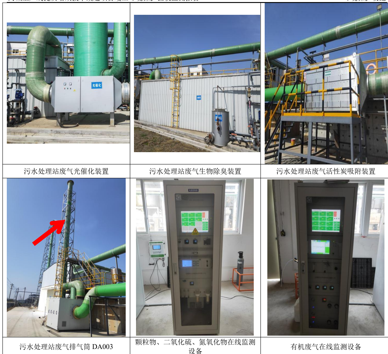
图 4.1-7 项目废气收集处理措施图
