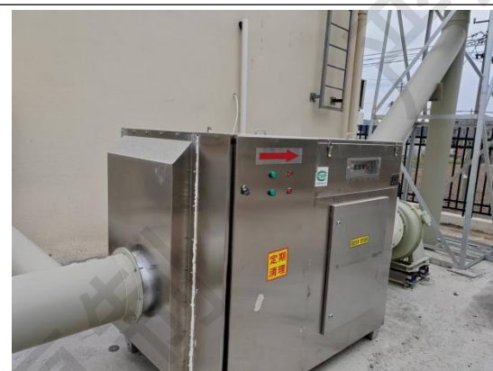
废气处理设施
