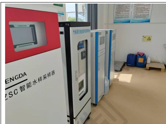
污水处理站在线监测
