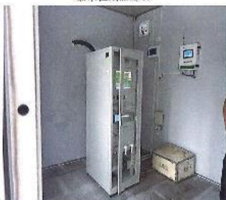
废气在线监测室
