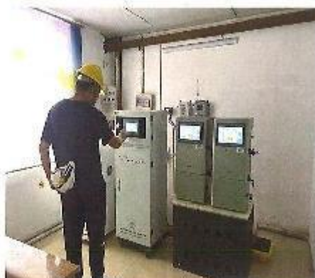
废水在线监测室
