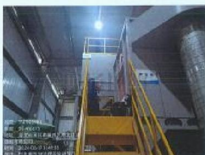
抛丸废气 2#治理设施进气口
