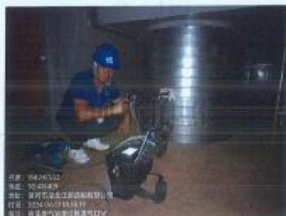
喷漆废气治理设施进气口 1#
