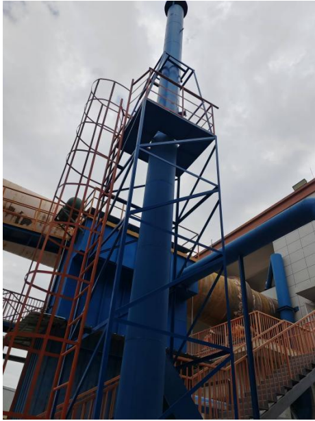
窑头废气排气筒
