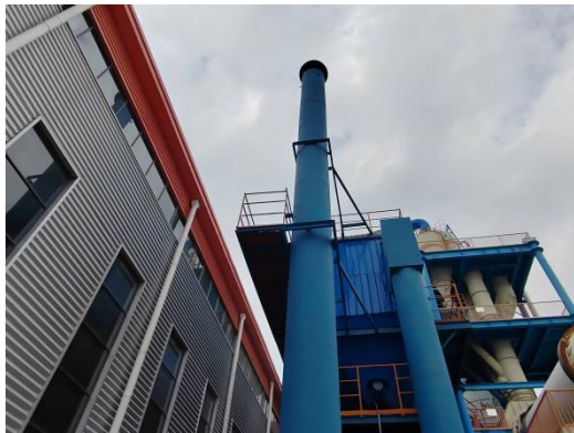
炉窑废气排气筒
