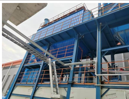
高温布袋除尘器
