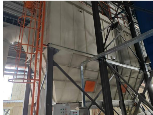
提升废气布袋除尘器
