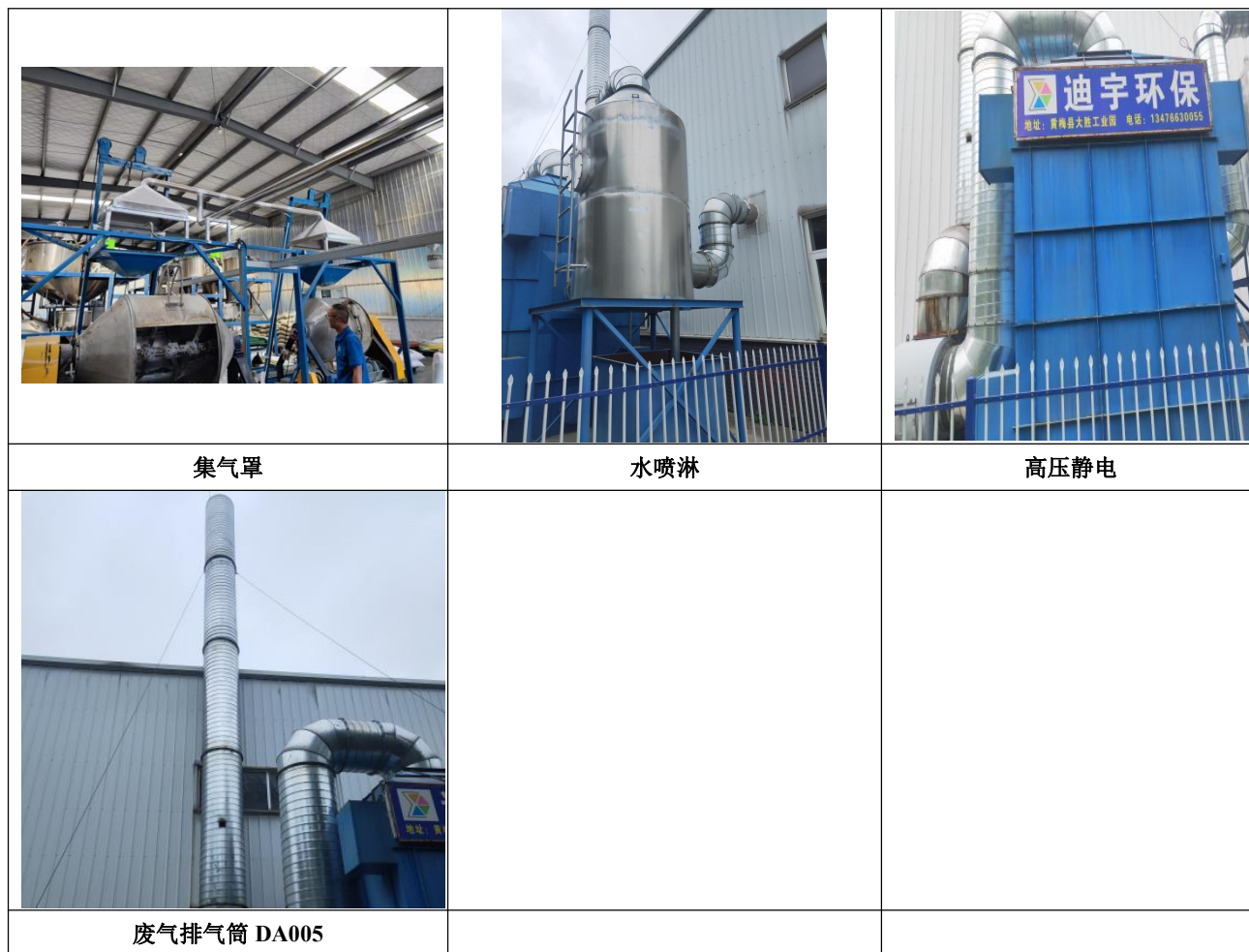
图 4-1-3 项目废气处理设施图片
