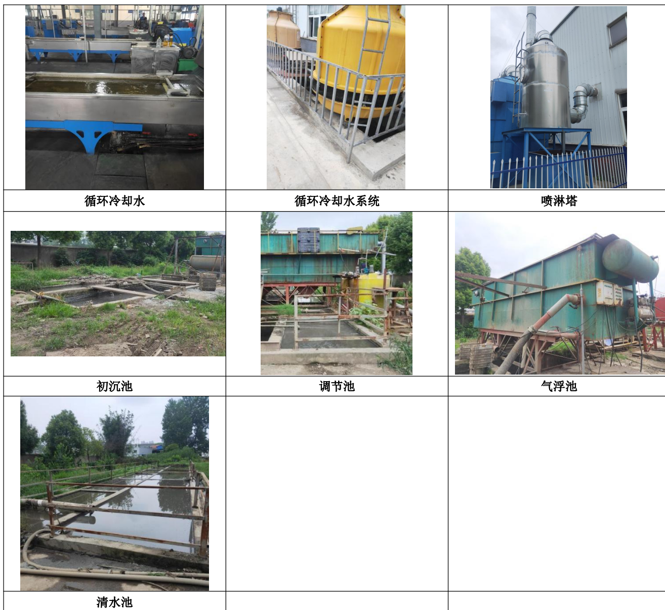
图 4-1-2 项目废水处理设施图片
