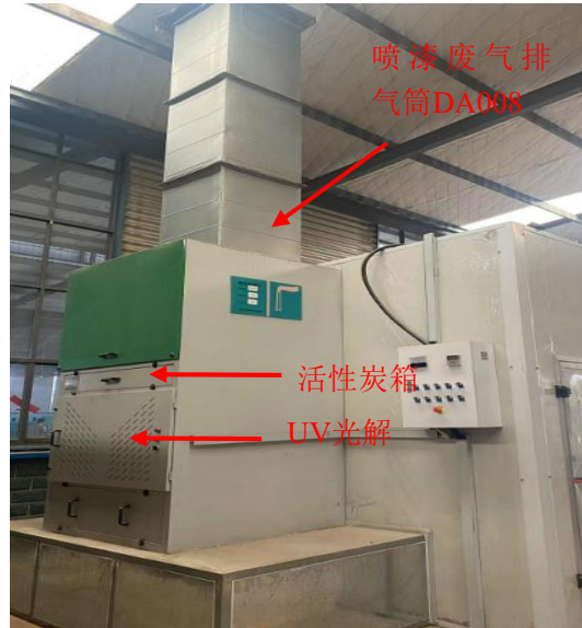
喷漆废气处理系统及排气筒
