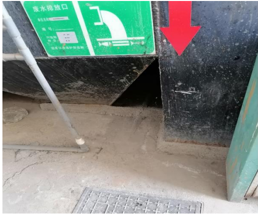
废水出水口及标识牌
