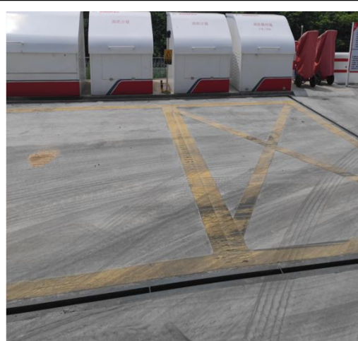
卸油平台环保沟
